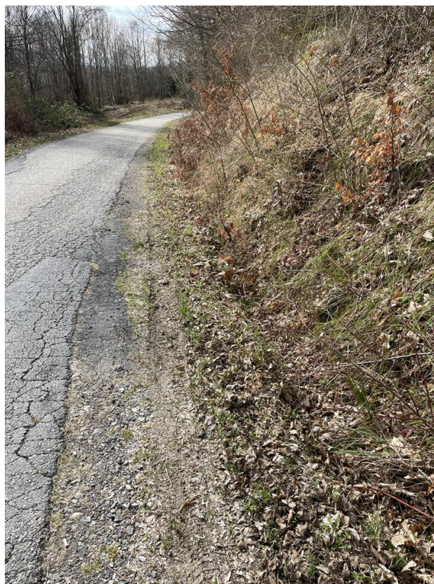
Slika 5. Odvodni jarak obrastao vegetacijom
