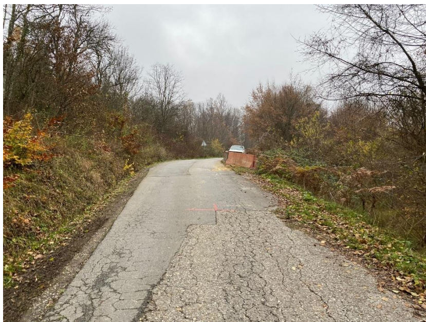
Slika 4. Uzdužne pukotine u asfaltu
